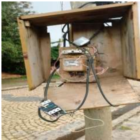
a) Power meter
